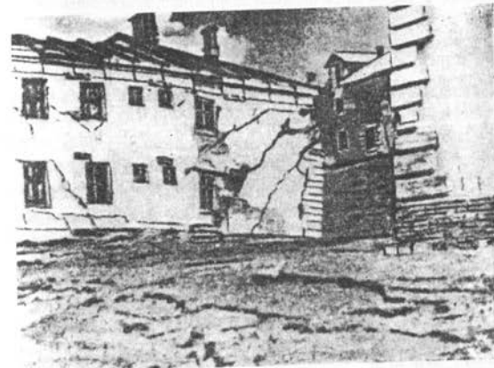
Рис. 30.1. Деформация здания на подрабатываемой территории
