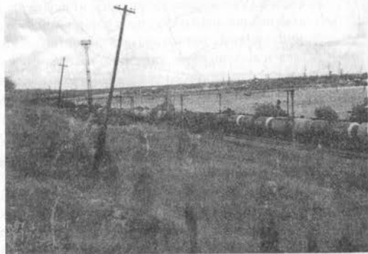
Рис. 28.4. Оползневой склон (правобережье р. Дон)
