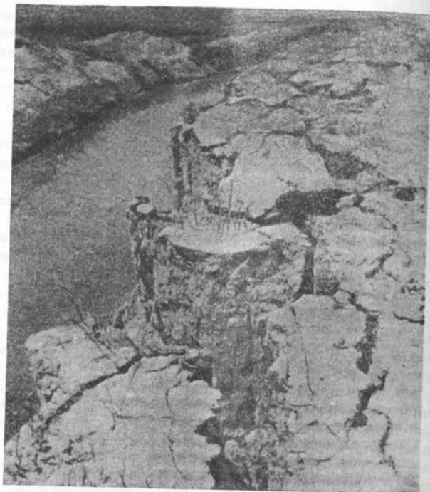
Рис. 23.5. Просадка лессовых грунтов Северо-Ташкентского канала, происшедшая в течение первых трех месяцев его работы (фото Х.А. Аскарова)
