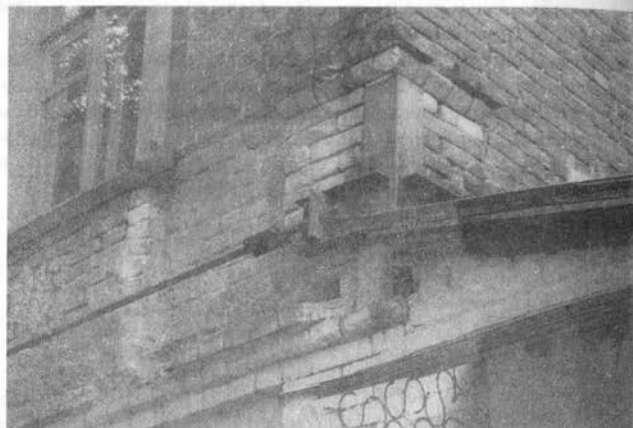
Рис. 23.9. Металлические стяжки по периметру стен деформированного здания
