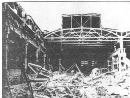
Рис. 27.3. Карстовый провал в основании корпуса завода «Химмаш» (г. Дзержинск)
