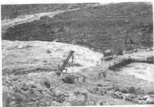
Рис. 26.8. Мост через реку Урух (Северная Осетия — Алания), разрушенный селевым потоком
